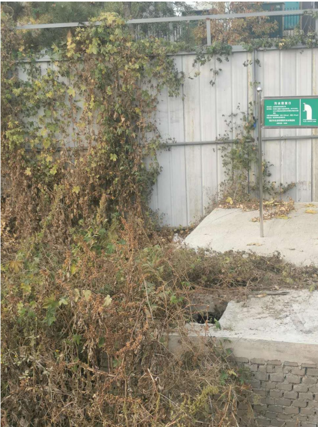
厂区废水排放口及排放标识
